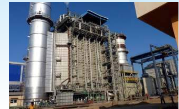
HRSG for Gas Turbines
